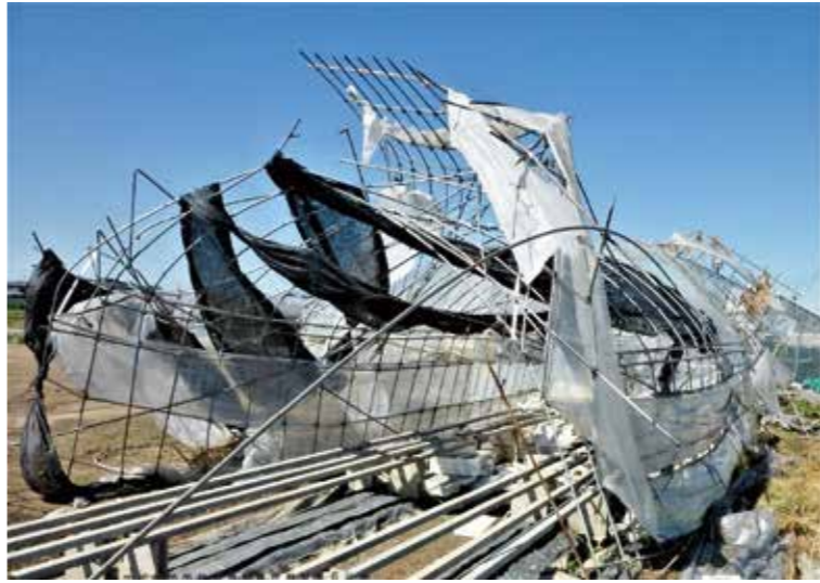
台風による施設の全壊
